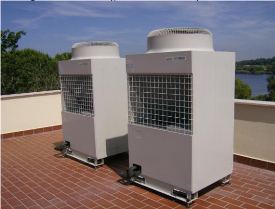
refrigeratore 1 (per refettori)
