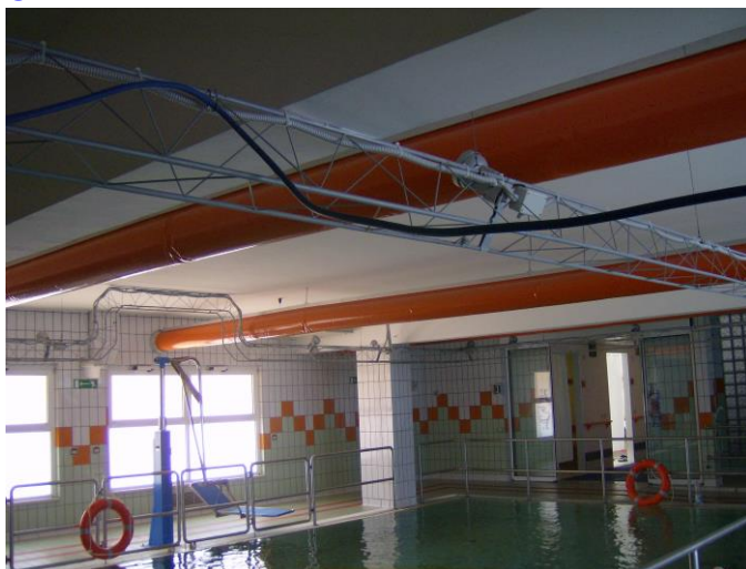
U.T.A. con canalizzazioni
